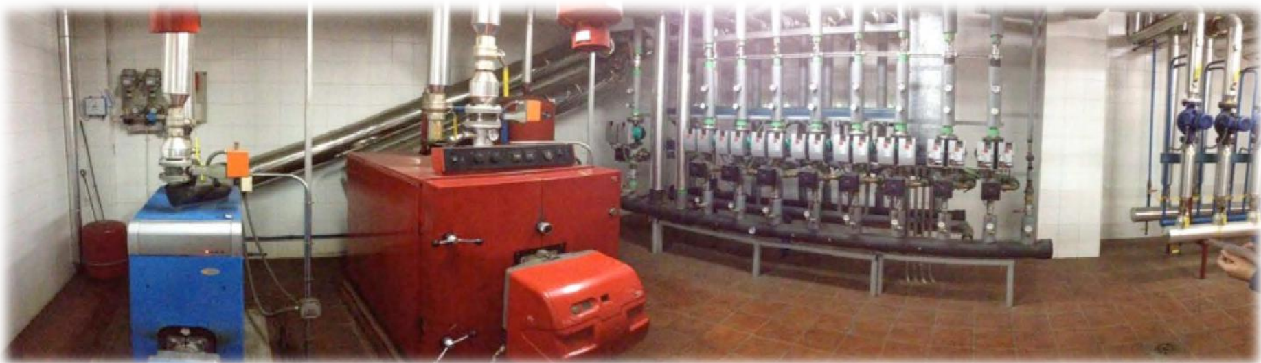
Estado sala calderas previo a la actuación
